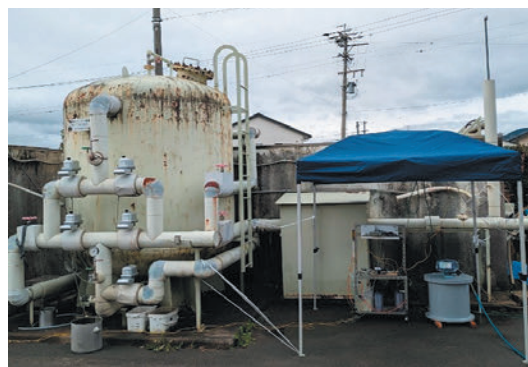
地下水浄化システム実証試験（試作カートリッジによる特性評価）
